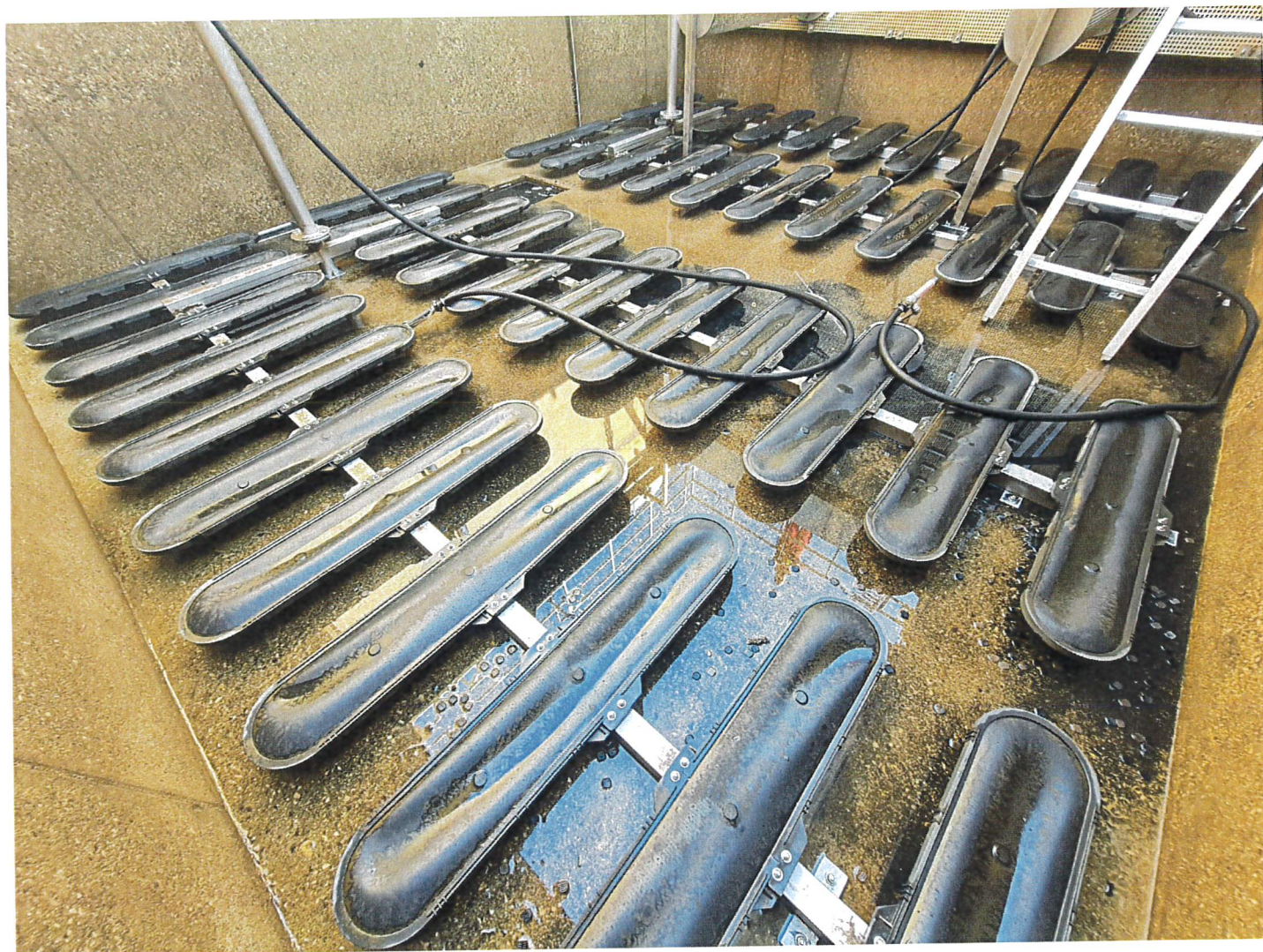
Etat actuel – Dégradation globale et diffusion d'air moins performante
